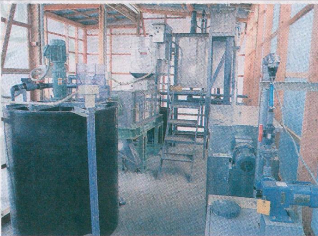
志津川水産食品仮設工場のリセルバを採用した廃水処理施設
